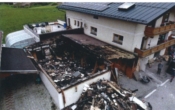
Brand in einer Tischlerei Brandursache: elektrischer Defekt
